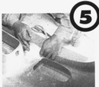
マットを修理面に裏側から貼っていく。薄く細かくちぎって貼らないと、密着せず、強度が出ない
